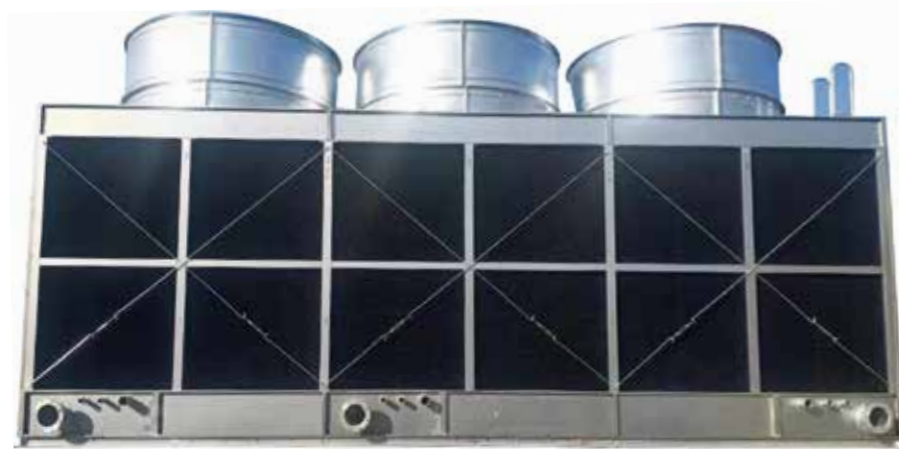
冷却塔 Cooling Tower
